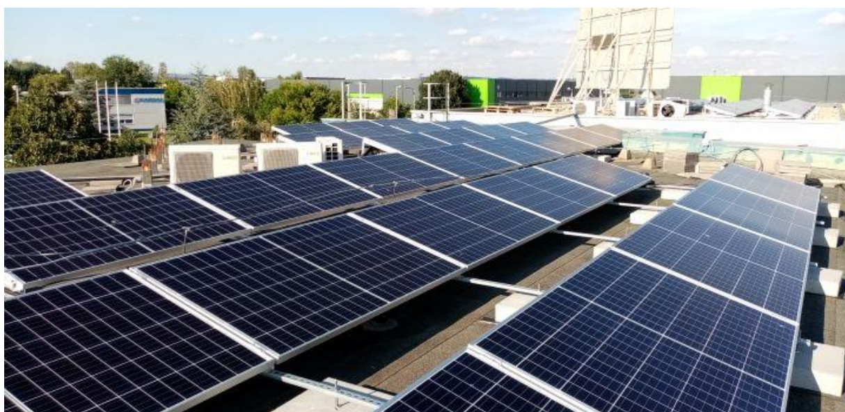
45,56 kWp névleges teljesítményű napelemes rendszer
